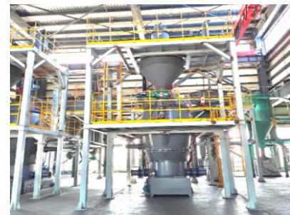
250kw 球化设备应用现场 Отгруженная установка на 250кВт.
